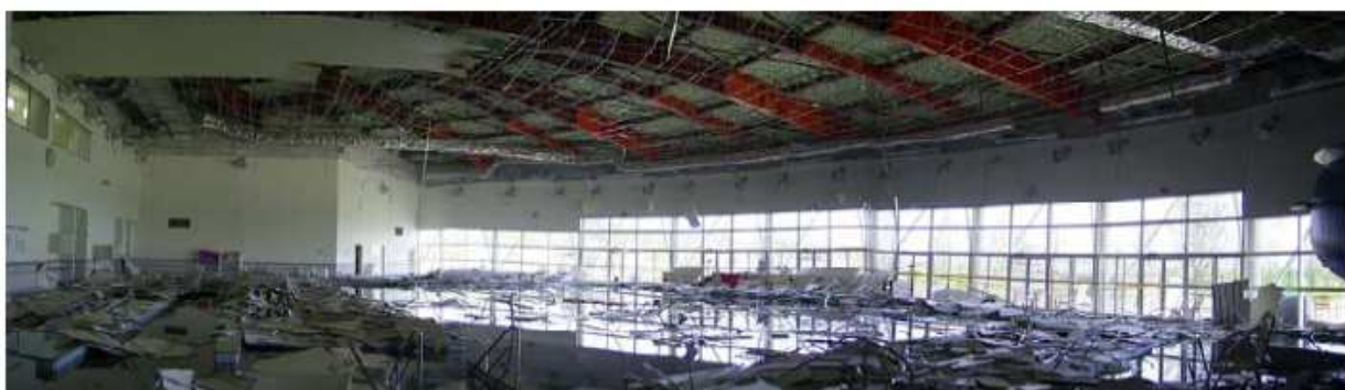
(a) 2005 年宮城県沖の地震における被害事例 [2]
