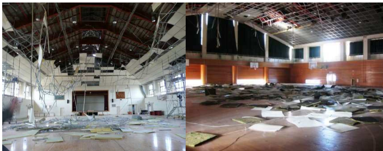
(b) 2011 年東日本大震災における被害事例 [3]
